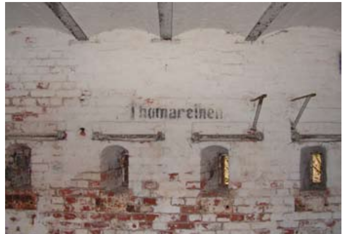
Wieża południowa, zachodnia ściana od strony Tomaryn. Nad oknami widać pręty do mocowania stalowych płyt fot. L. Pietrzak
