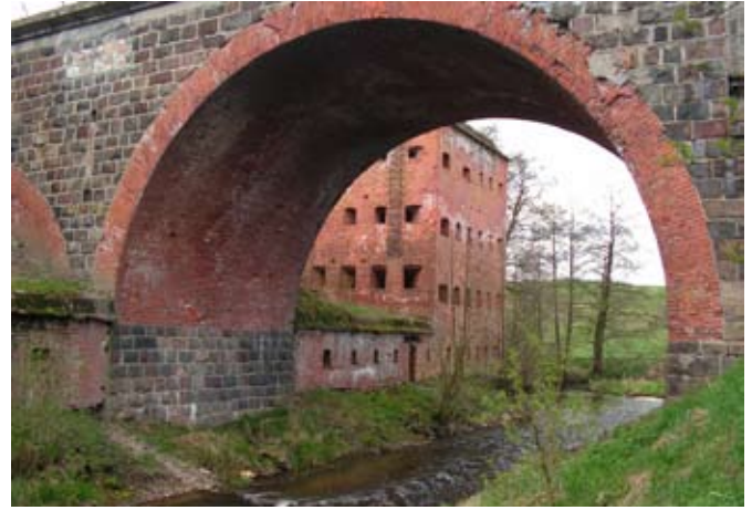
Poterna i wieża południowa. W przeszle wiaduktu znajduje się duże pomieszczenie fol. L. Pietrzak
